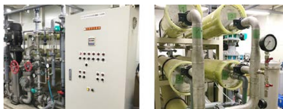
逆浸透膜(RO)ろ過装置
