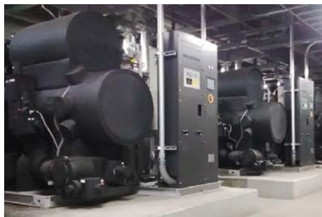
アンモニア冷凍機
